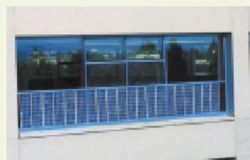
Gros plan sur les modules photovoltaïques en remplacement du garde-corps de fenêtre (source : ST Microelectronics).
