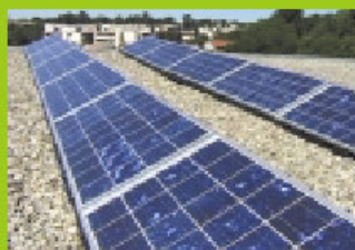
Modules PV posés sur la terrasse du lycée de La Frondaie (source : Apex bp solar).
